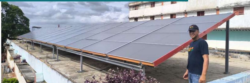
Pannelli solari installati per le macchine che disidratano la frutta
